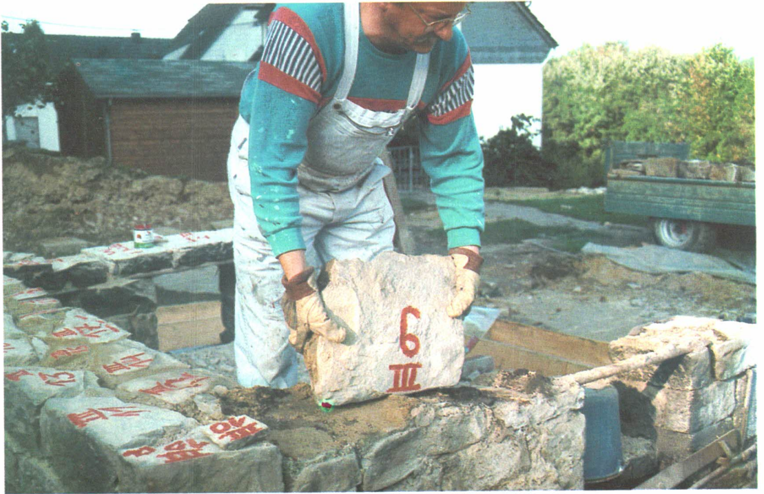
Grauwacke-Bruchsteinmauerwerk des Sockelgeschosses wird für den originalgetreuen Wiederaufbau vor dem Abbruch dokumentiert.
