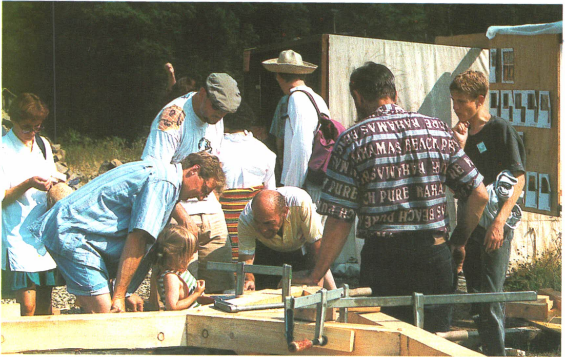
Das Handwerk der Zimmerleute kann hier nicht erlernt, jedoch aus nächster Nähe betrachtet werden. Es gibt große und kleine Interessenten.
