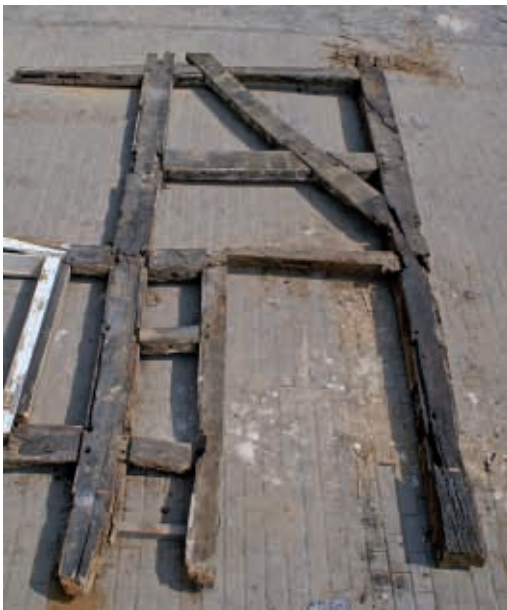
Fachwerkpuzzle: in den Ständern sind neben den jüngeren Tür- und Fenstereinbauten noch die Falze und Zapflöcher der ehemaligen kleinen Fensteröffnungen gut zu erkennen.
